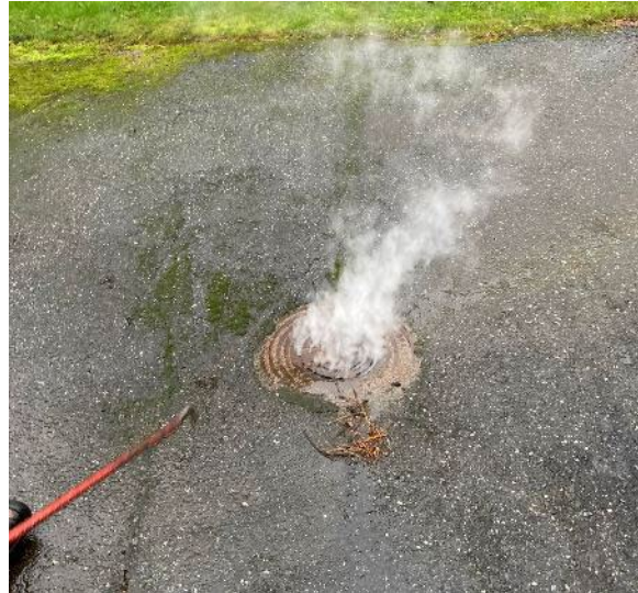
Kuva 5. Jätevesiviemäriin yhteydessä oleva hulevesikaivo
